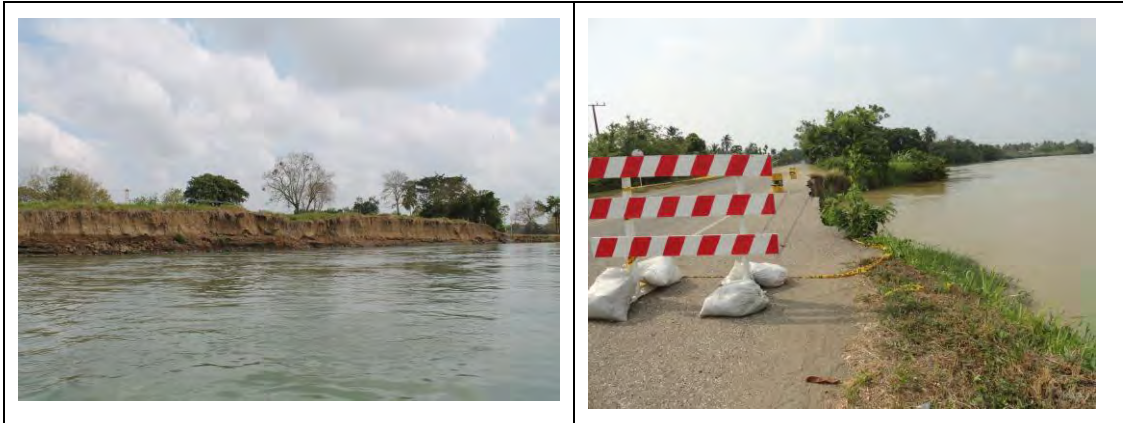
Fotos: Puntos con Erosión Severa: Recorrido GGR – CVS (2014)
